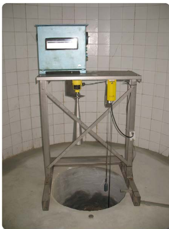
Registrador mecánico, codificador digital y sensor radar
